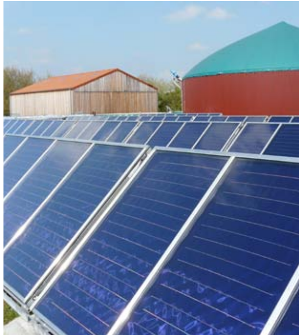
In der Modellstadt Wanzleben wurde der Versuch unternommen, die Wärmebereitstellung im Fernwärmesystem mit Solarthermie und einer Biogasanlage zu unterstützen. Quelle: Stadt Wanzleben
